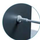
Estetycznie wykończone okablowanie
