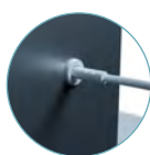
Estetycznie wykończone okablowanie
